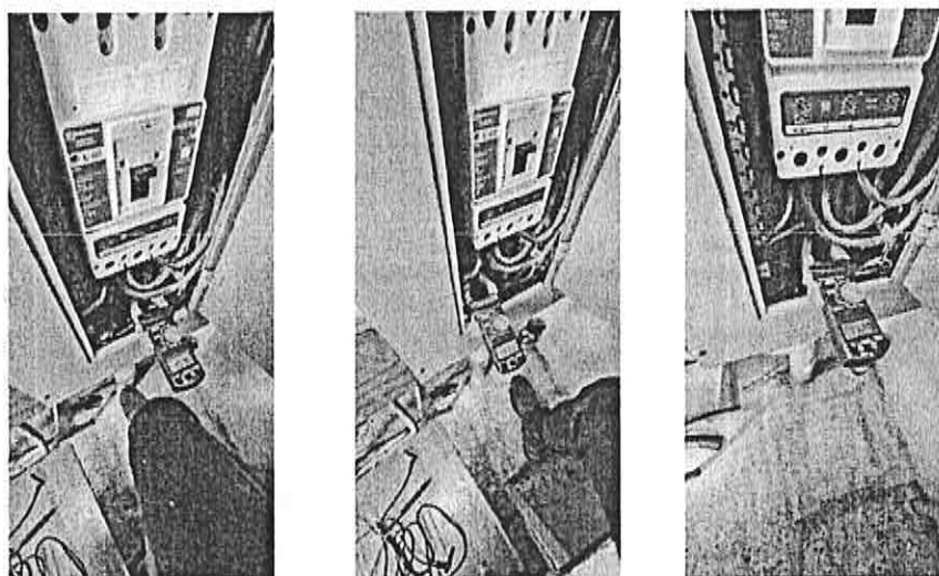
Figura 3. medición de corriente en la acometida principal del edificio de aulas realizadas en la fase A, B y C.
